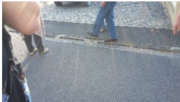
Defekte Kantsteine Rosssteinstr. Siehe Foto
